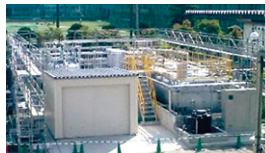
バイオガス設備
