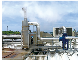
廃蒸気回収装置
