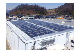
太陽光パネル
