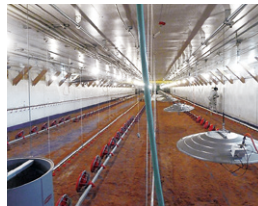
既設ガス暖房機
