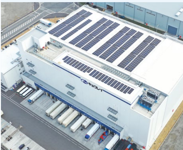
2022年2月に設置した(株)キョクレイ本牧物流センターの太陽光パネル
