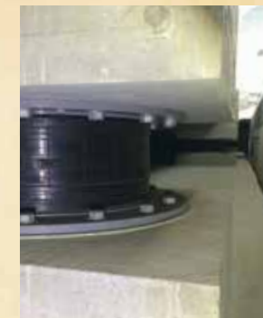
冷蔵庫棟の免震装置
