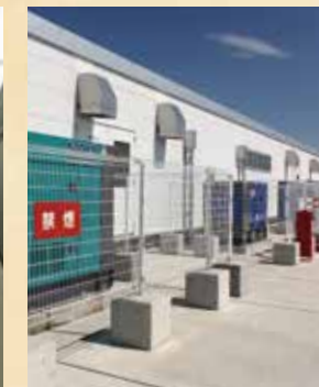
非常用発電装置
