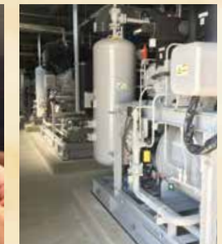
自然冷媒冷凍装置
