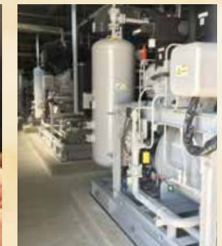
自然冷媒冷凍装置
