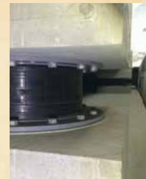
冷蔵庫棟の免震装置
