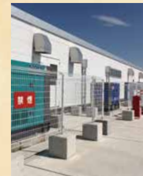
非常用発電装置
