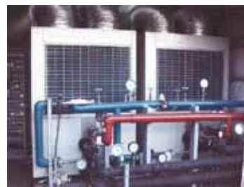
船橋工場のヒートポンプ
