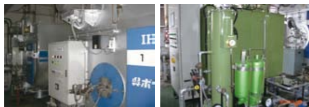
船橋工場の廃食用油と燃料の混合装置(左)、中冷 廃食油ボイラー(右)
