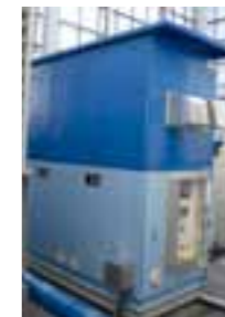
廃熱回収設備
