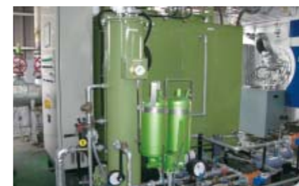
廃食用油を処理し燃料を混合する装置
