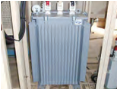
(株) ニチレイ・ロジスティクス四国 鳴門物流センター 高効率変圧器
