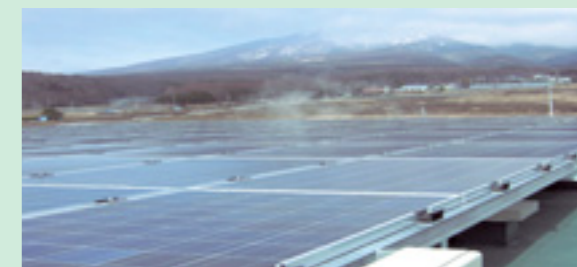
太陽光パネル
