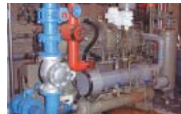
アンモニア冷却システム
