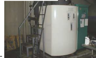
貫流ボイラー
