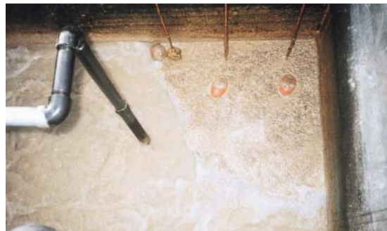
調整槽(油分溶解槽)
