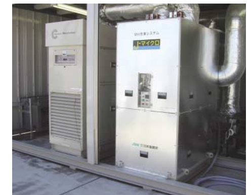
技術開発センターに設置された試験装置 左：マイクロガスタービン、右：MH冷凍システム
