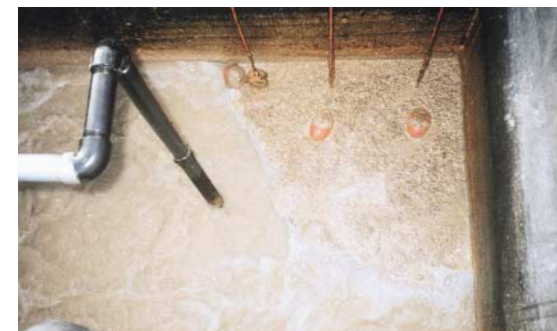
調整槽（油分溶解槽）
