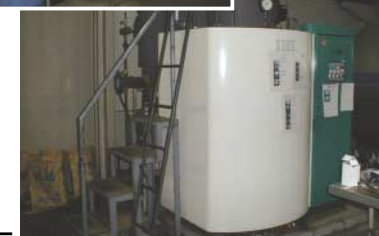
貫流ボイラー
