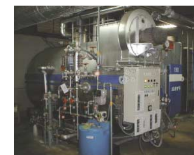
炉筒煙管ボイラー
