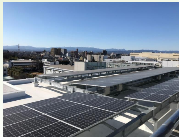
太陽光パネル
